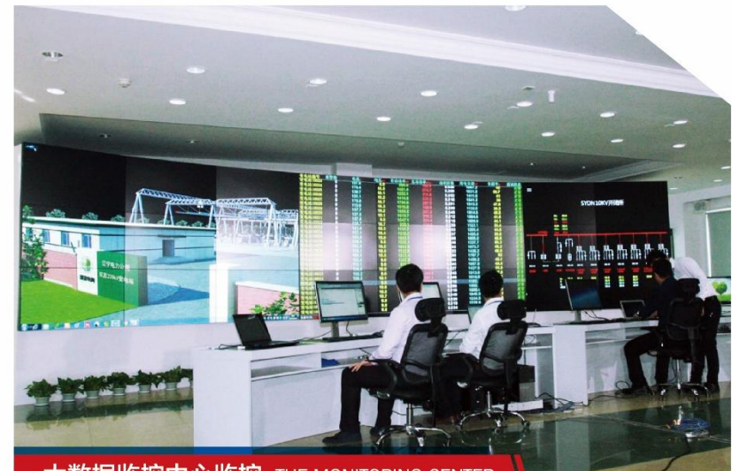
大数据监控中心监控 THE MONITORING CENTER
